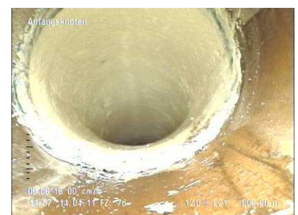
verklebter Kurzliner in einem Abwasserrohr
