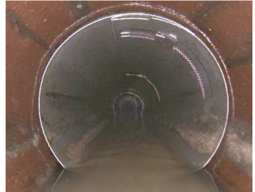
eingebaute Innenmanschette in einem Schmutzwasserrohr
