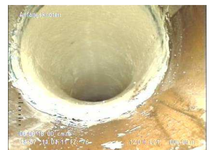
verklebter Kurzliner in einem Abwasserrohr
