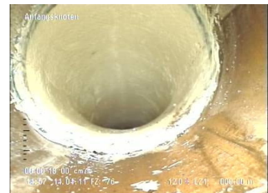
verklebter Kurzliner in einem Abwasserrohr
