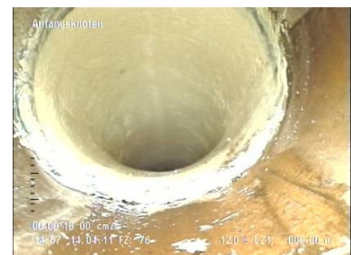
verklebter Kurzliner in einem Abwasserrohr
